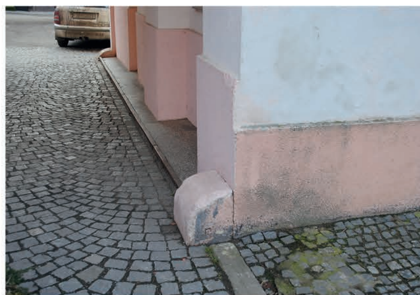
projevy vlhkého zdiva
