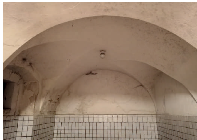
VLHKOST, NEUDRŽOVANÉ INTERIÉRY
