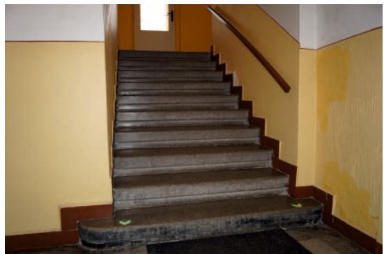
KVALITNÍ ŽULOVÉ SCHODIŠTĚ, NEVHODNÉ NÁTĚRY NA STĚNÁCH
