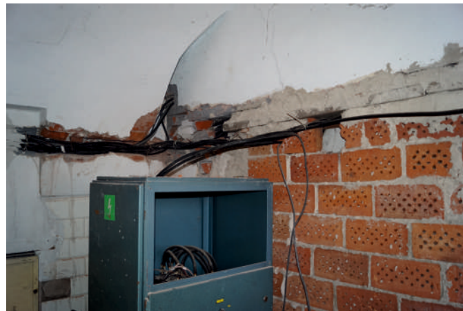
NECITLIVÉ ZÁSAHY A PŘÍČKY NARUŠUJÍCÍ KLENEBNÉ PROSTORY
