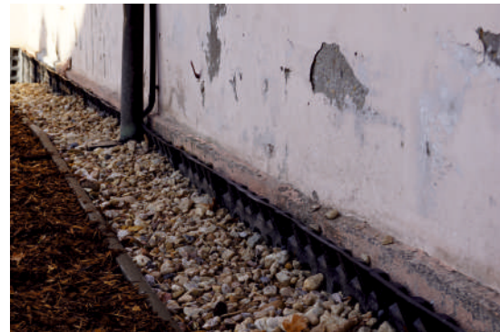
VLHKOST, NARUŠENÉ OMÍTKA, ŠPATNĚ ŘEŠENÁ DRENÁŽ
