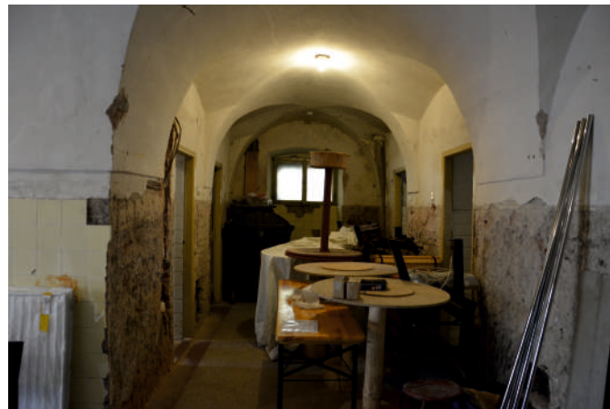
LÁZNĚ-> SKLAD, NARUŠENÉ OBKLADY, VLHKOST, STARÁ OKNA
