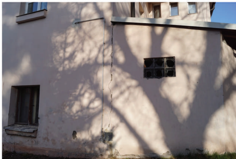
trhlina spôsobená nevhodným založením prístavby
