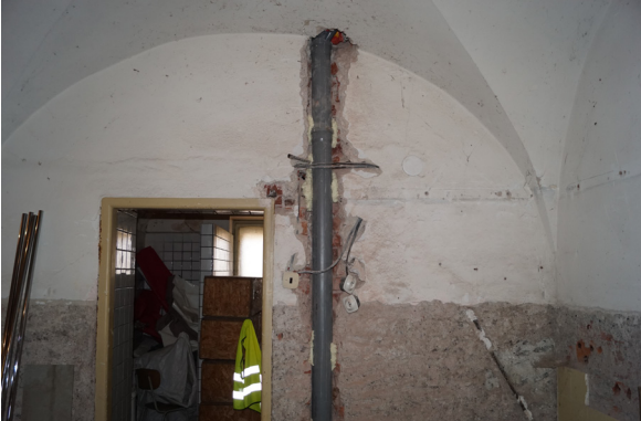
Vzlínání vlhkosti zdiva v soklové části
