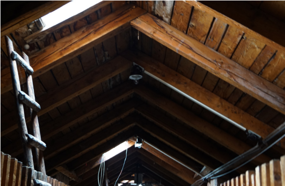
Koroze měděné plechové krytiny
