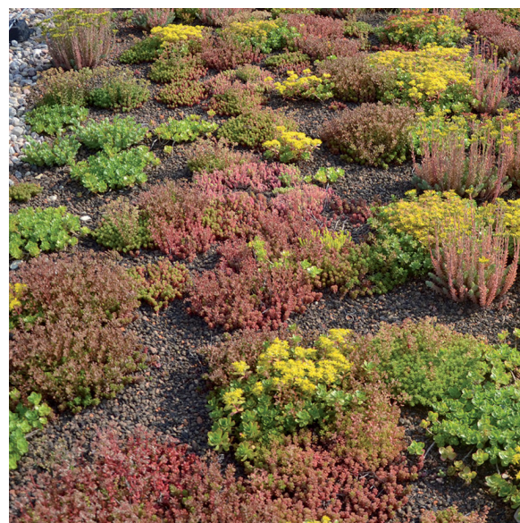
Rozchodníková vegetační rohož na střeše
