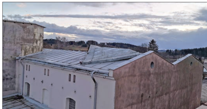
Z výjezdu č. 2-4 – uvolněná střecha na budově v areálu Polytex
